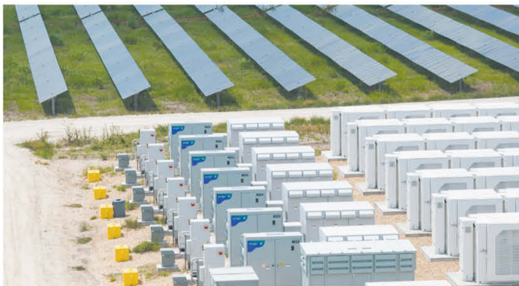
Prolec diseñó transformadores preparados para solucionar los retos de la generación de energía en el futuro
