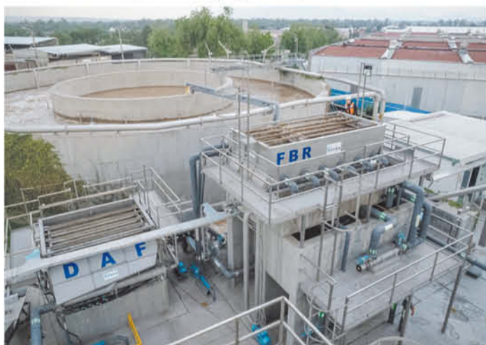
Qualtia cuenta con tres plantas tratadoras de aguas residuales
